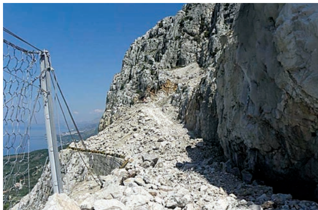
Urušeni i nasuti dio ceste
